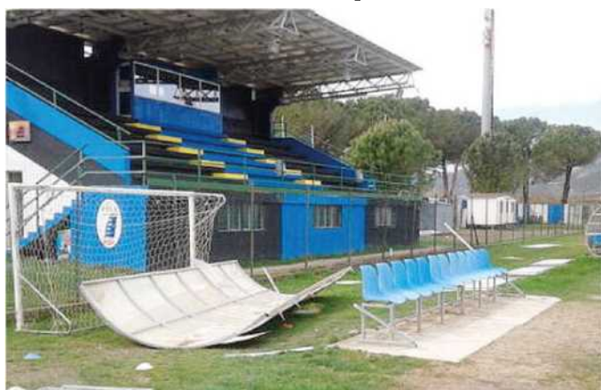
Completamente distrutta una delle panchine
