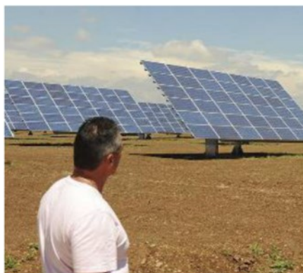
Impianto fotovoltaico motivo del contendere tra Calcinaia green e Comune di Calcinaia al Tar
