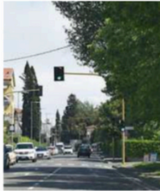
Il semaforo con T-Red installato in viale America a Pontedera
